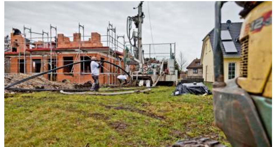
Schäden während der Bauphase können Bauherren teuer zu stehen kommen. Es lohnt sich daher, rechtzeitig passende Versicherungen abzuschließen. Foto: djd/Bauherren-Schutzbund
